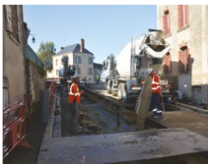
Le réseau fait peau neuve
